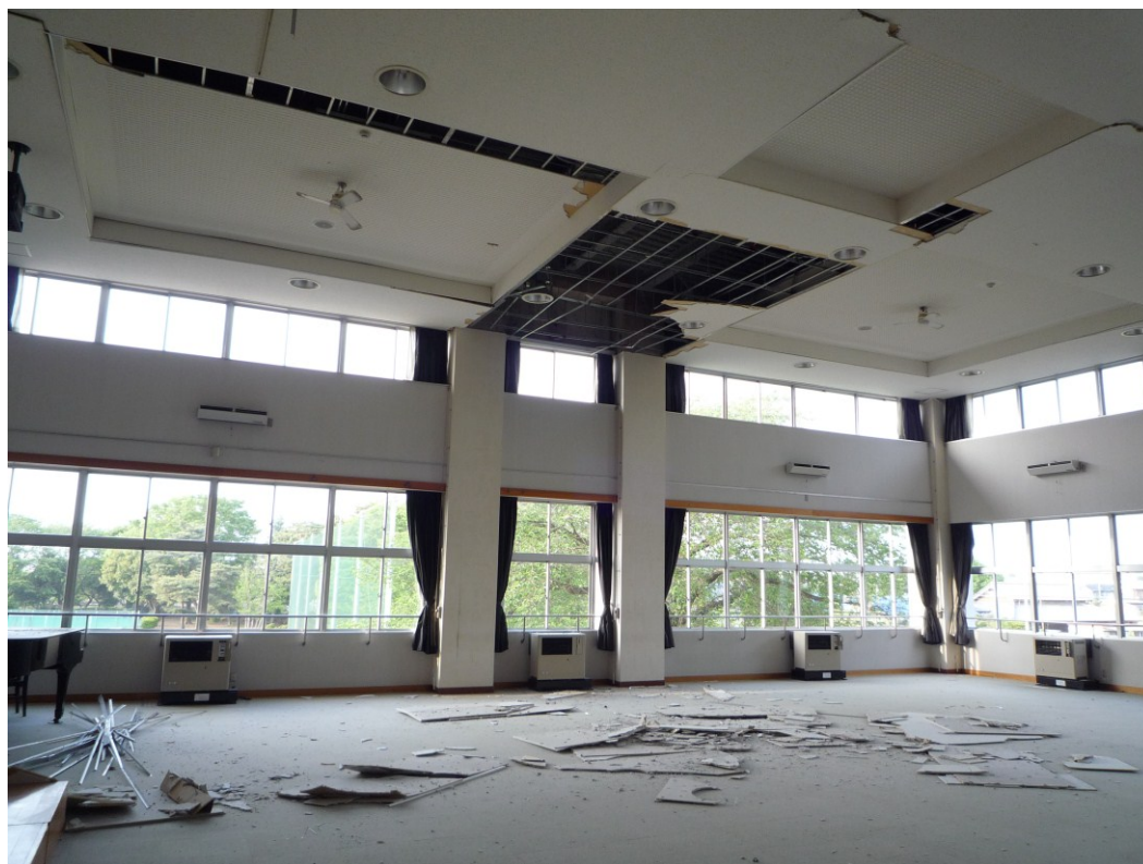
中村中学校・多目的室の地震直後の状況。
